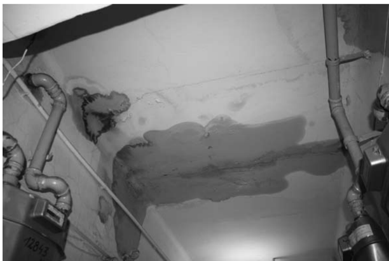
W bloku przy Skłodowskiej jest stropodach. Sufit jest jednocześnie dachem. Że dziurawym, widać już na korytarzu
