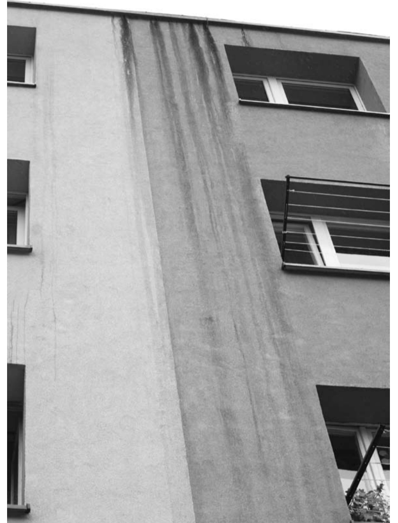
Na elewacji wyremontowanego w październiku 2009 roku budynku już utworzyły się brzydkie zacieki
